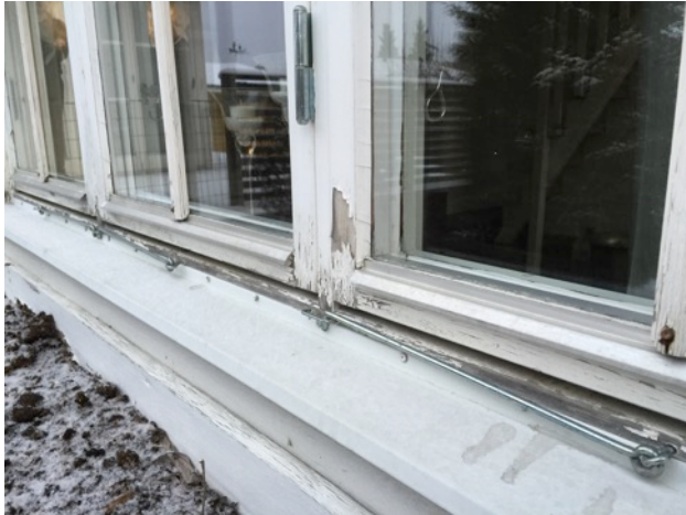
Färg och kittsläpp på äldre fönster
