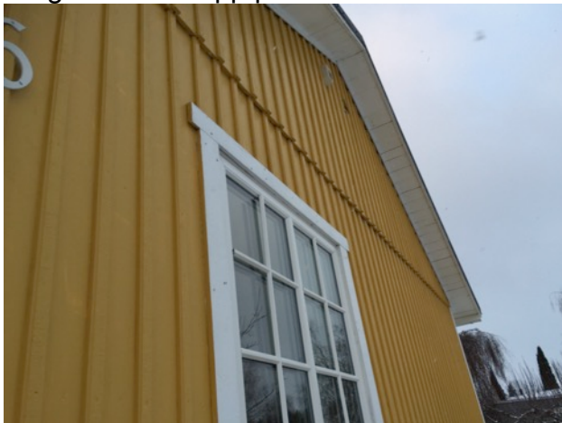
Överbleck saknas ovan fönster
