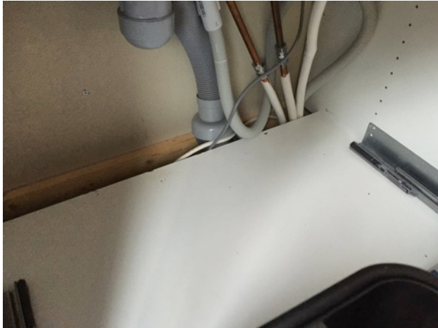
Ej fuktsäker botten i diskbänkskåp
