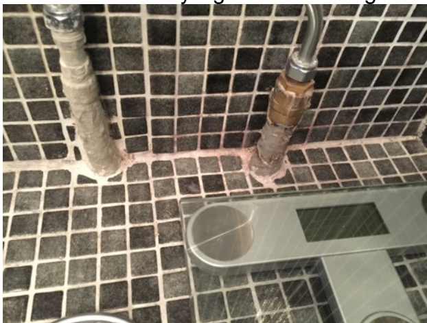
Trycksatta rör i våtrumsgolv
