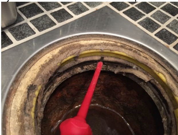
Brunnsmanchett synlig under klämring
